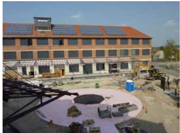
Abb. 9: Der Innenhof während der Bauphase. An der neu aufgetragenen Deckenisolierung lässt sich der Umfang des Eisspeichers ablesen. Foto: Landeshauptstadt Stuttgart, Amt für Stadtplanung und Stadterneuerung
